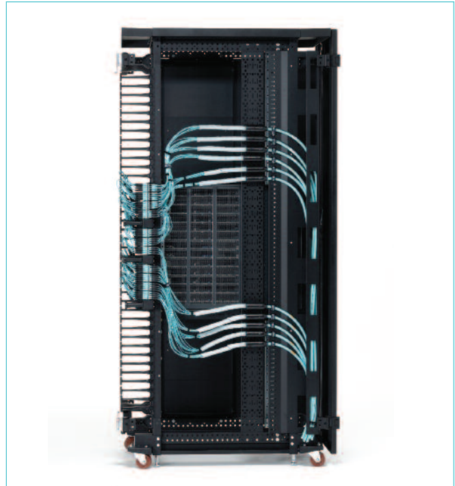
Gabinete TeraFrame serie N de CPI con el Sistema de administración de fibra CPI | Foto LAN952
