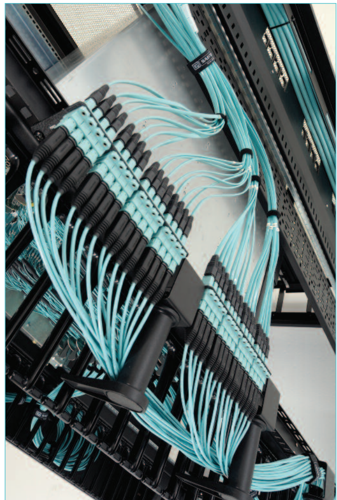
Arnés del Sistema Zero-U de Corning Cable Systems | Foto LAN920
